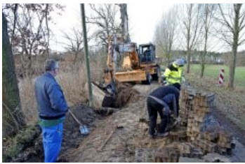
Biber haben die Böschung entlang der Straße im Dreetzer Ortsteil Michaelisbruch untergraben. Der Schaden wird repariert. Foto: Beckmann
